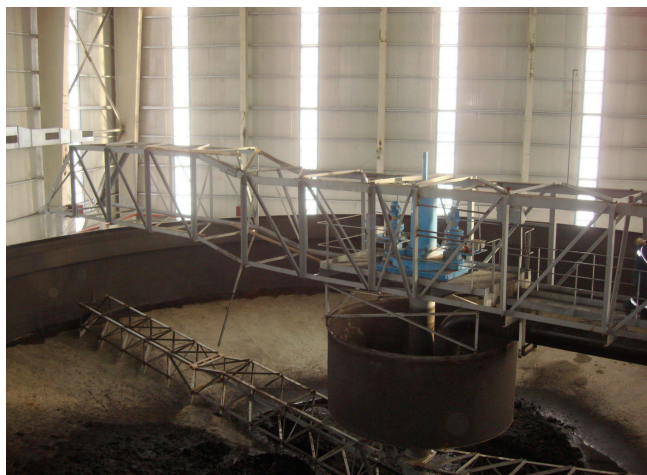
Обрушение моста радиального сгустителя в результате ошибки в расчетах несущей способности конструкции.
