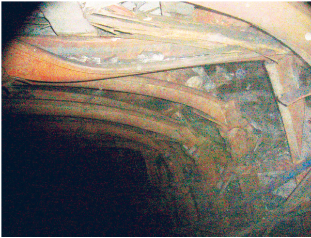
Рис. 1. Состояние повторно используемого вентиляционно-го штрека горизонта 917 м с крепью КМП-А5.
