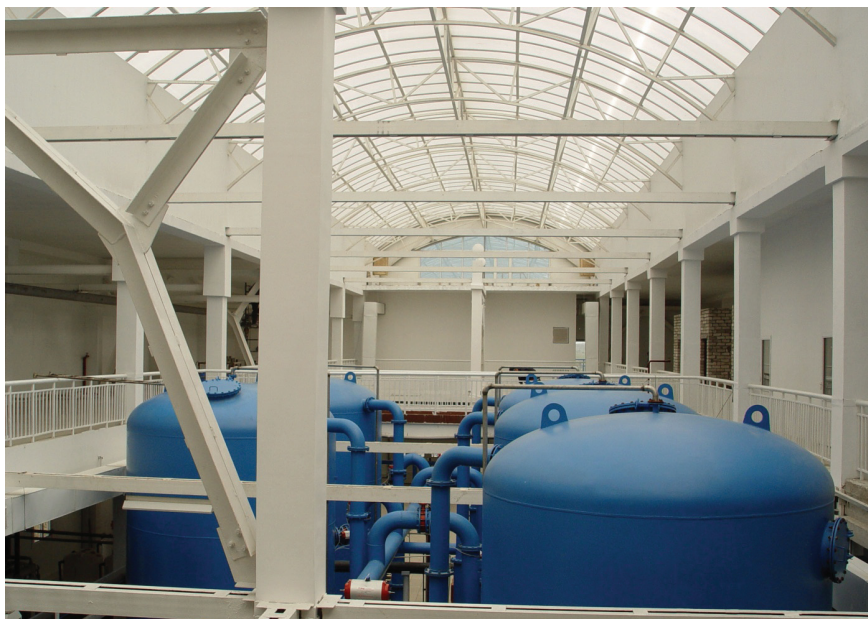
Рис. 1. Рабочий зал станции очистки шахтной воды.
