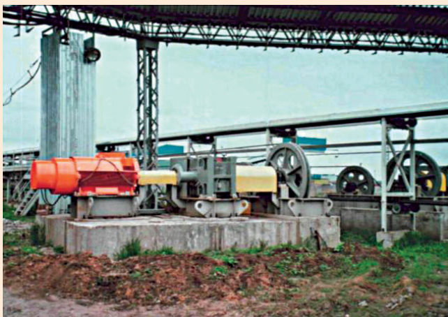
Приводная станция одноставного канатно-ленточного конвейера.
