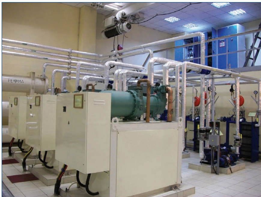
Рис. 1. Общий вид теплонасосной установки на ПСП «Шахта Благодатная».
