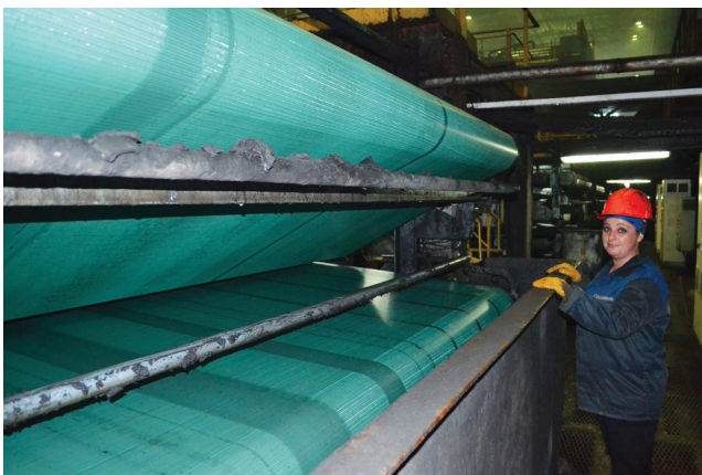
Главный корпус. Ленточный фильтр-пресс для обезвоживания отходов крупностью 0 – 0,2 мм.
