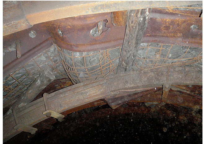
Рис. 1. Нарушение работы штанговых анкеров за лавой из-за значительной дезинтеграции пород на шахте «Степная».
