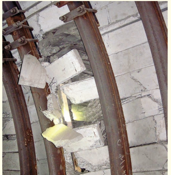
Рис. 4. Деформация межрамных затяжек.
