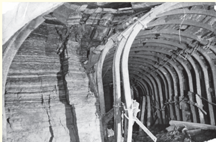
Рис. 2. Расслоение пород приконтурного массива.
