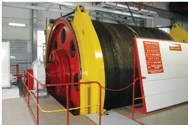
Новая подъемная установка на блоке № 2.
