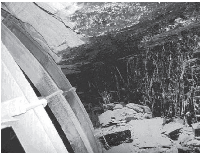
Рис. 5. Вывалы угля под песчаником во 2-м южном конвейерном штреке шахты «Алмазная».
