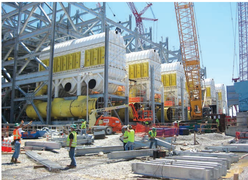
Рис. 3. Монтаж сушилок кипящего слоя HDC 9250 на тепловой электростанции IGCC (США, штат Миссисипи).
