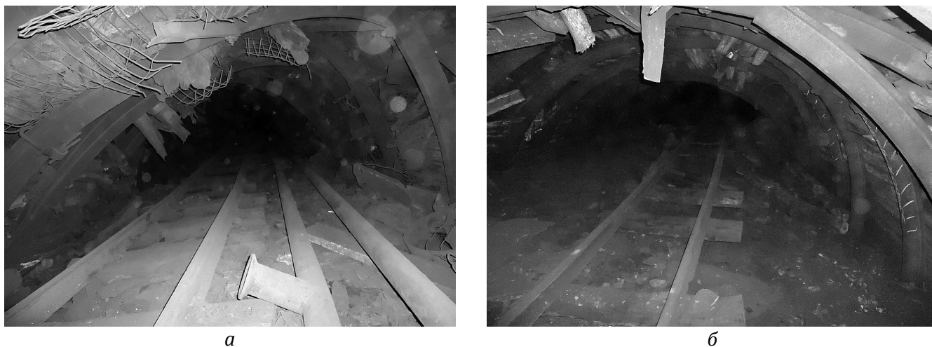
Рис. 4. Состояние конвейерных штреков в зоне нарушения после отработки выемочных полей лавами: а – конвейерный штрек № 6; б – конвейерный штрек № 5.
