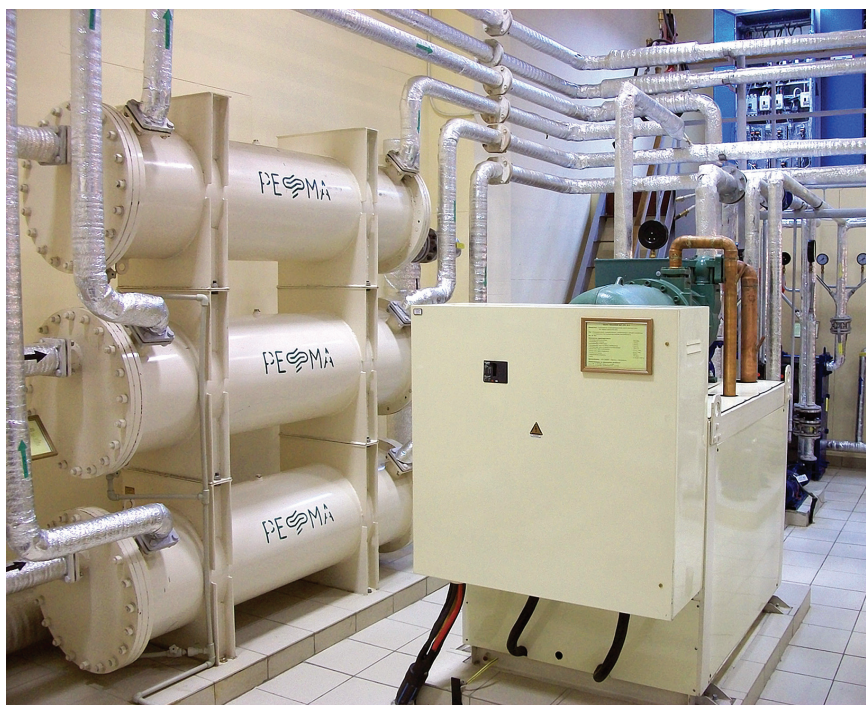
Рис. 2. Общий вид теплонасосной установки на шахте «Благodatная».
