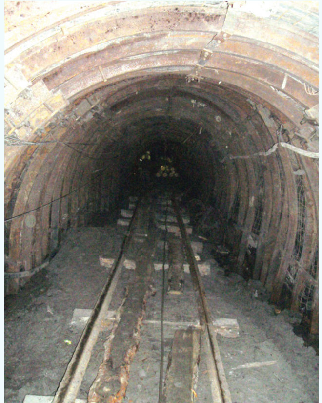
Рис. 7. Состояние бортового штрека № 631 на самом неблагоприятном участке для его поддержания (район ПК 28).
