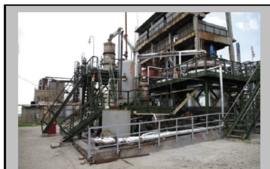
Установка по подготовке смолистых отходов к утилизации
