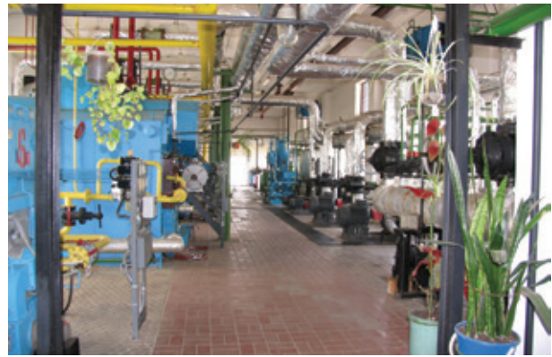
Рис. 8. У котельній РПЧ-9 Одеса-Застава I
