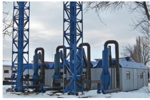
Рис. 6. Сучасна модульна котельня на твердому паливі (вугілля) ВЧДР-4 Помічна
