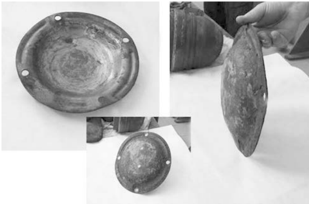
Рис. 59. Деформация смотровой крышки
