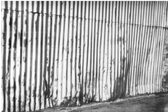
Фото 3. Корозія огорожувальних конструкцій зерносховища
