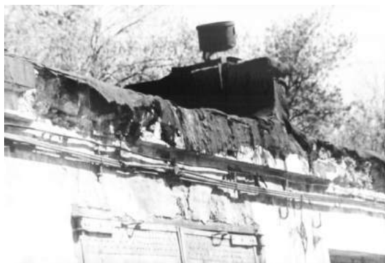
Фото 4. Руйнування карниза і покриття зерносховища
