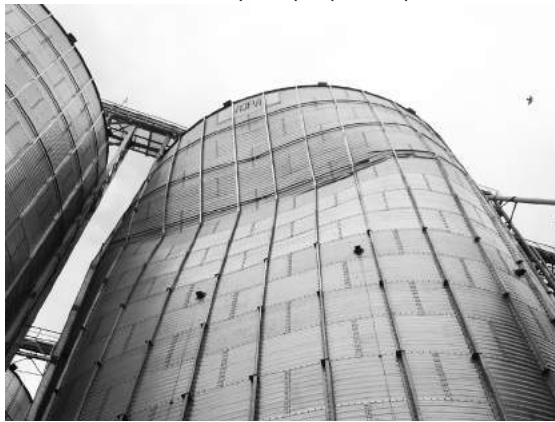
Фото 2. Втрата загальної стійкості ребер жорсткості та деформативність оболонки сталевих силосу
