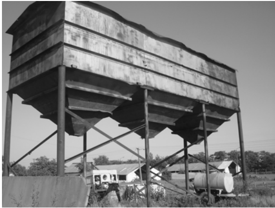
Фото 6. Корозія конструкцій сталевго бункера для перевантаження зерна і відсутність окремих елементів вертикальних зв'язків
