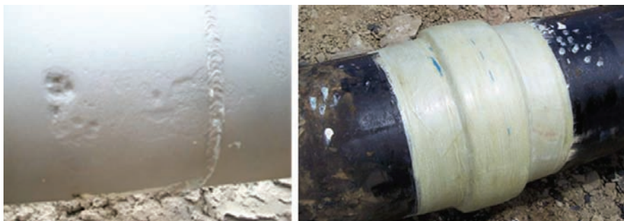
Рисунок 1 – Вигляд дефекту в стінці трубопроводу та ремонтної накладки [1]
