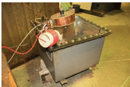
Рисунок 5 – Фотография импульсного трансформатора ИТ 1
