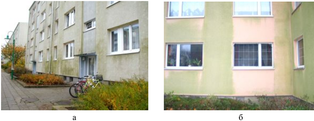
Рис. 1 – Примеры биоповреждений фасадов жилых зданий: а – г. Буххольц (4 года эксплуатации); б – г. Киль (7 лет эксплуатации).
