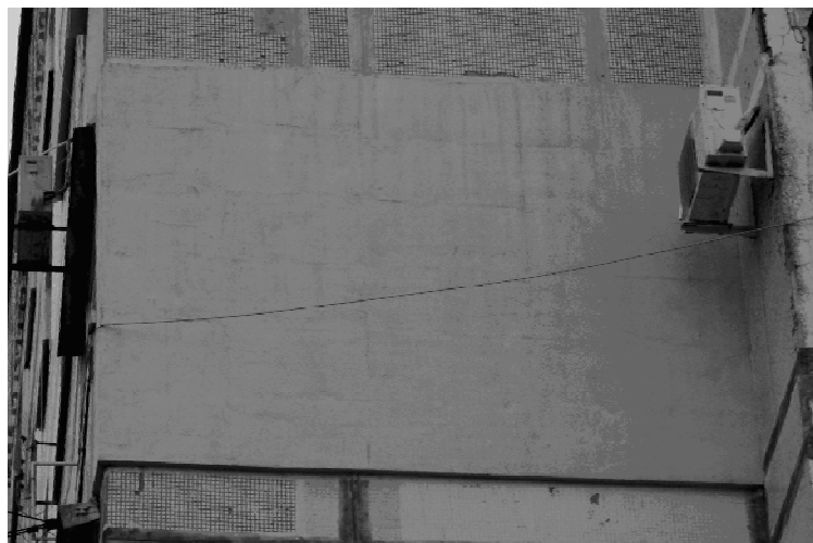
Рисунок 1 – Вид деформированных плит утеплителя.
