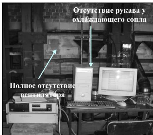
Рисунок 1 – Отсутствие элементов охлаждения.
