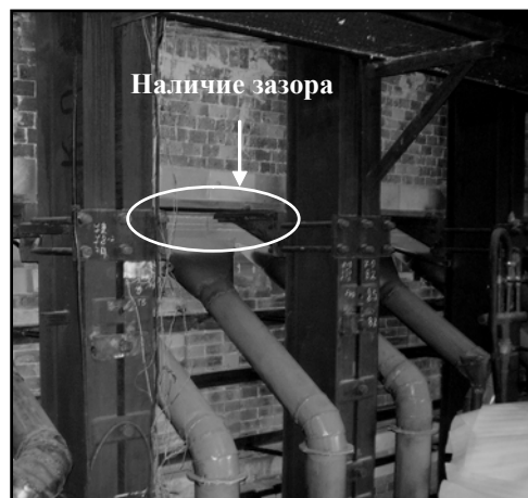
Рисунок 2 – Наличие зазора в кладке печи.
