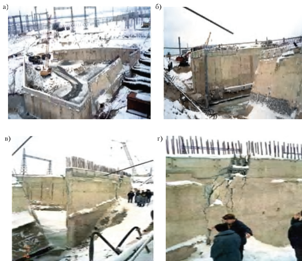
Рисунок 3 – Конструкции циркуляционной насосной станции после обрушения секций её торцевой стены: а) общий вид станции после аварии; б) участок обрушений секций; в) элемент торцевой стены в угловой части; г) фрагмент зоны деформации на стыке секций.
