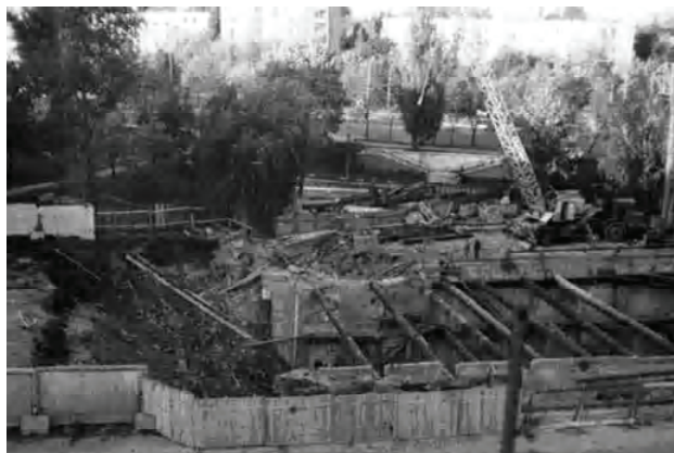
Рисунок 1 – Котлован КДВУ после аварии.
