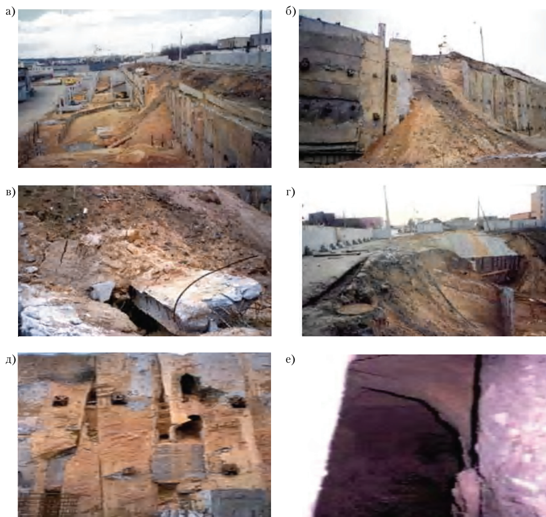
Рисунок 2 – Элементы подпорной стены после аварии: а) общий вид котлована; б) зона обрушения; в) обрушившаяся секция; г) канализационный люк возле зоны обрушения; д) дефекты бетонирования секций траншейных стен; е) суффозионная полость в зазоре между секциями.
