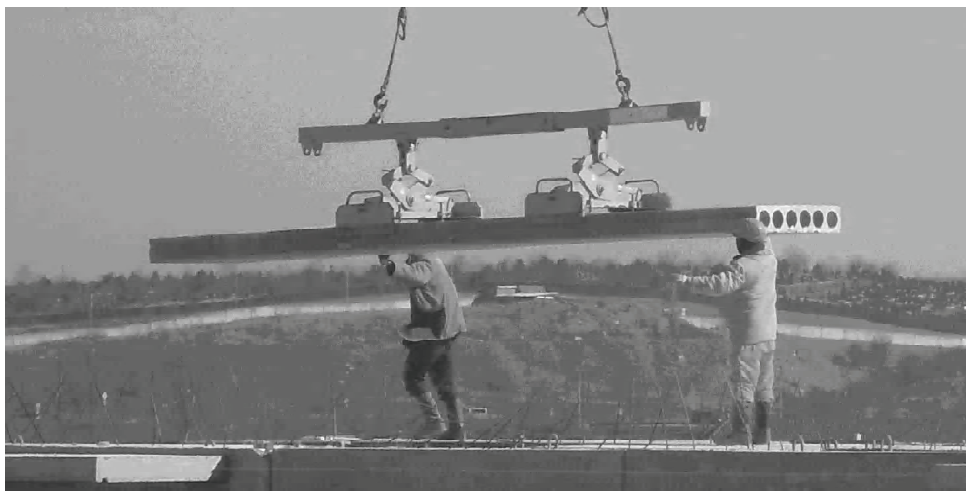
Рисунок 1 – Обратный выгиб предварительно напряженной пустотной плиты в процессе ее монтажа траверсой с клещевыми захватами.
