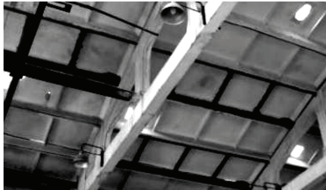
Рисунок 5 – Усиление продольных и поперечных ребер железобетонных плит покрытия внешним армированием композитным материалом на основе углеродных волокон.
