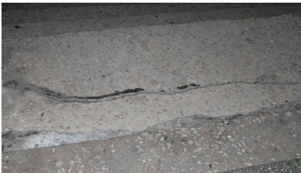
Рисунок 2 – Деформация пола на 2 этаже главного корпуса ДонНАСА.
