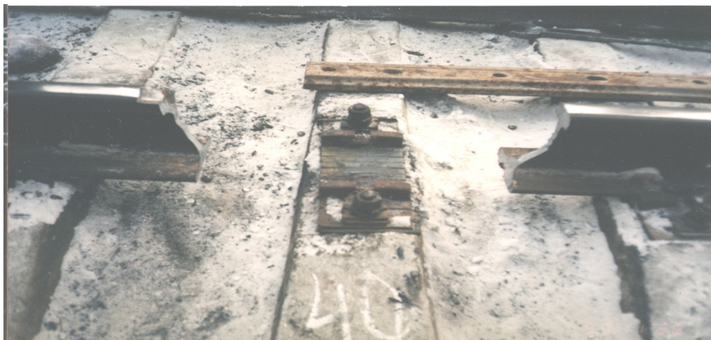
Рис. 4. Излом рельсовой плети по дефекту 21 с наложением дефектов 30Г, 10, 11
