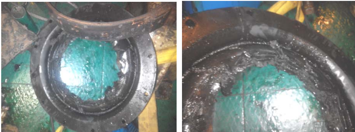
Рис. 2. Зруйнований пружний елемент базової муфти
