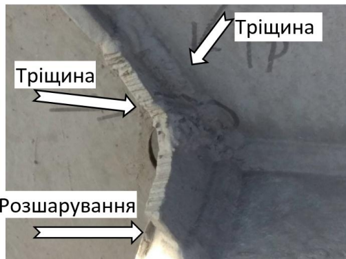
Рис. 9. Фотографія ділянки металоконструкції з виявленими дефектами
