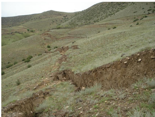
Рис. 2 Оползневые смещения на склоне Муровдагского хребта
