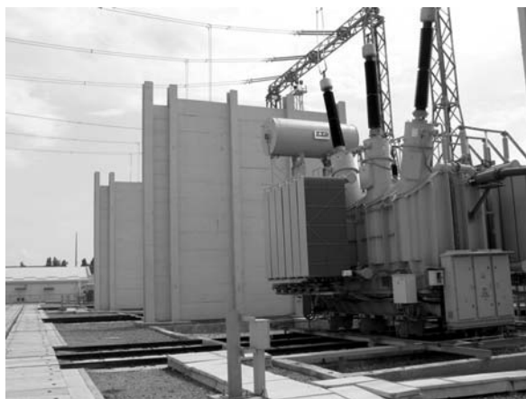
Рис. 3. Силовой трансформатор предприятия «Днепросталь»
