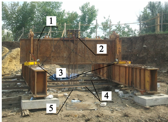
Рис. 3. Положение стенда в процессе испытаний: 1 – стенд анкерный СА-600; 2 – гидродомкраты; 3 – насосные станции с манометрами; 4 – реперная система с измерительными приборами; 5 – опытная свая
