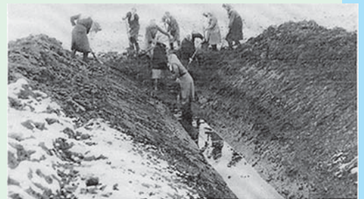
Осушення перезволожених земель на Тернопільщині велося ще за часів Австро-Угорщини. До сьогодні діє гончарний дренаж, побудований ще в XIX столітті у селах Гончарівка Монастирського і Личківці Густинського районів
