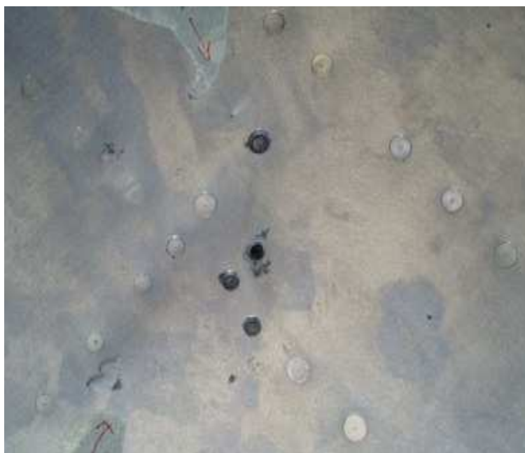
Рис. 8. Вид ззовні на панель, ушкоджену щілинною корозією
