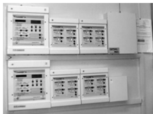
Фото 2. Приймально-контрольний прилад системи газового пожежогасіння
