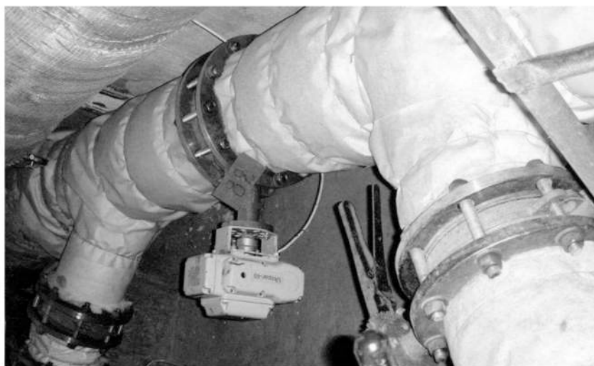
Рис. 3 Узел регулирования с косыми врезками и проходным регулирующим клапаном, установленный на ЦТП-6 в Коммунарском районе города Запорожье
