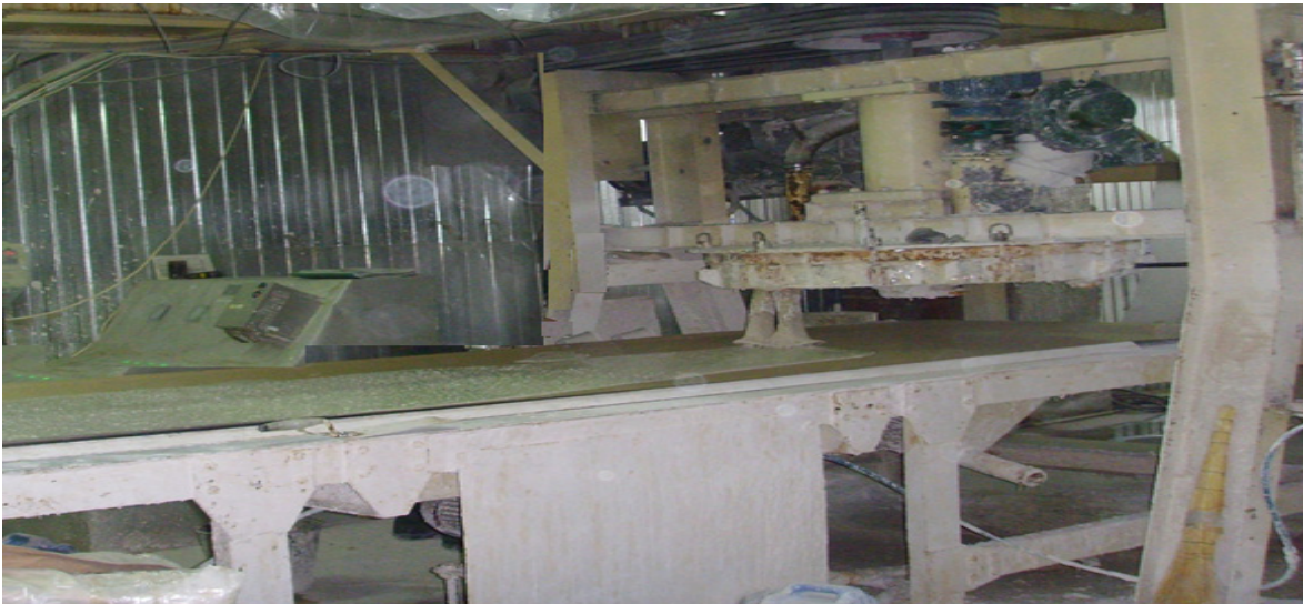
Рис. 2. Фрагмент технологічного обладнання, яке забезпечує процес підготовки гіпсоводної суміші та подачі на формувальний стіл
