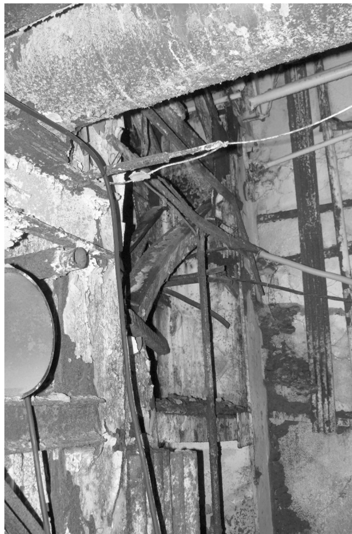
Рис. 2. Корозійні пошкодження та викривлення елементів сталевих каркасу (колони) в процесі експлуатації
