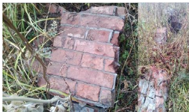
Рисунок 9. Фрагмент кирпич. кладки, разруш. арочный мост через канал
