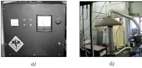
Рис. 2. Низковольтная часть генератора высоковольтных высокочастотных импульсов и общий вид экспериментальной установки
