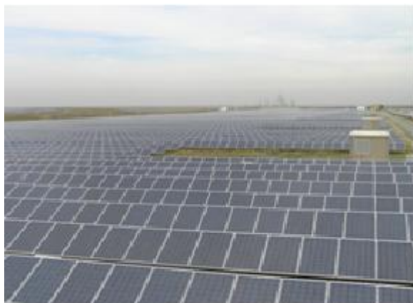
Рис. 1. Крупнейшая в Европе сетевая солнечная электростанция суммарной мощностью более 100 МВт, расположенная около г. Симферополя (с. Перово)
