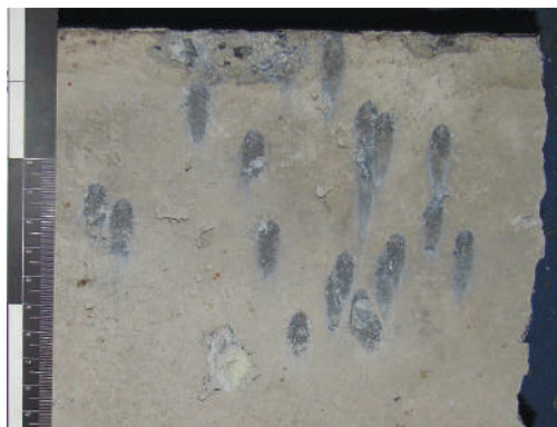
Рис. 4. Пошкодження бетонного блока, спричинені рикошетом 5,6 мм свинцевих куль
