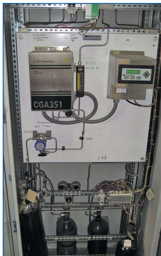
Рис. 2. Шкаф с газоанализатором контроля следов кислорода в производственном азоте
